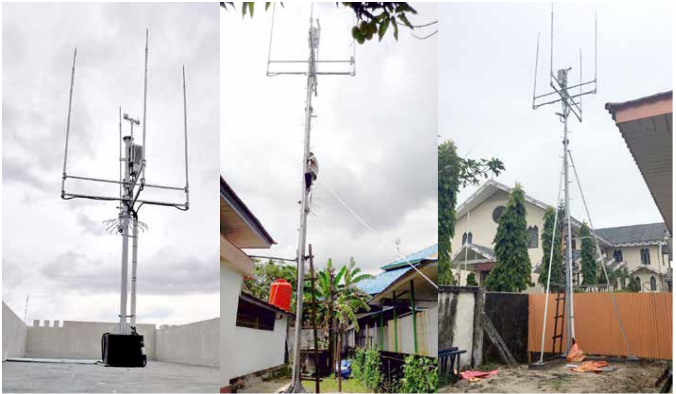
Pembangunan Sistem Monitoring Frekuensi Radio (Smfr) Stasiun Monitor Tetap Transportable
