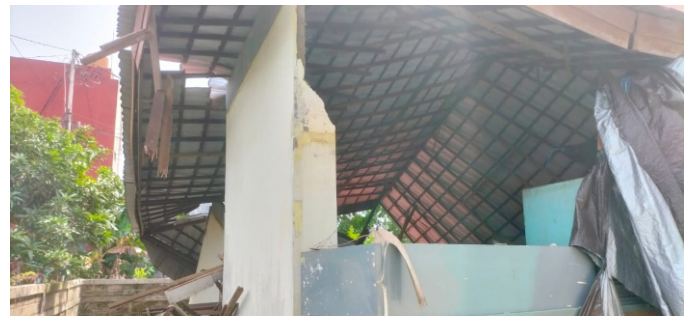
Dokumentasi Bangunan Roboh pada tanggal 18 Januari 2024
