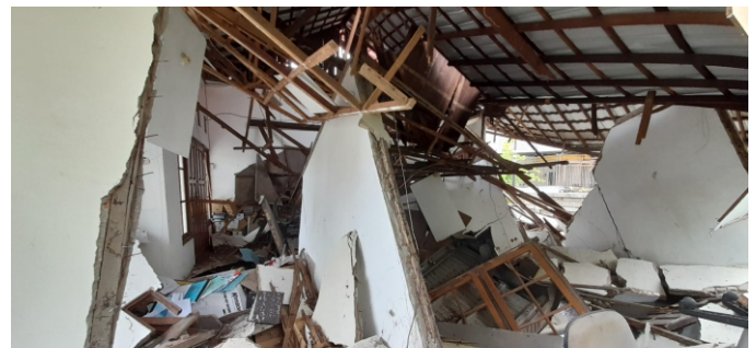
Dokumentasi Bangunan Roboh pada tanggal 18 Januari 2024
