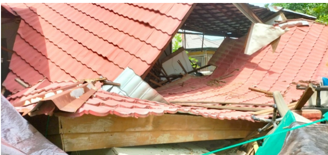
Dokumentasi Bangunan Roboh pada tanggal 18 Januari 2024
