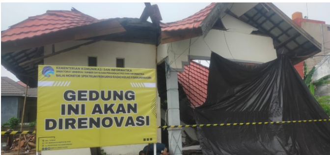
Dokumentasi Bangunan Roboh pada tanggal 18 Januari 2024
