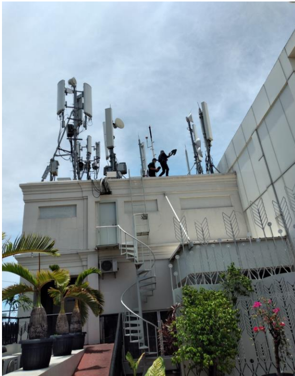
Monitoring Frekuensi 5,8GHz di rooftop Hotel HW Padang
